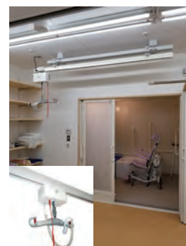
天井走行リフト
